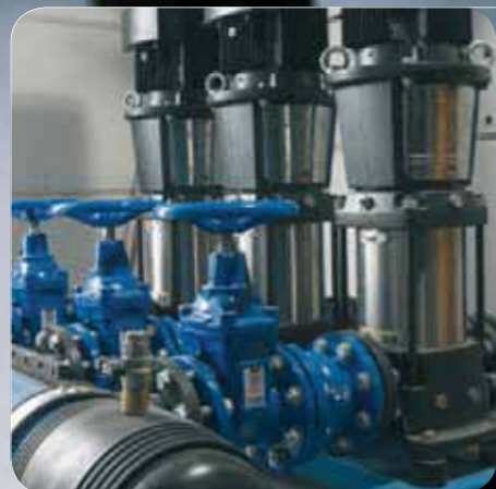
Grundfos установил: Оборудование повышения давления Насос повышения давления CR мощностью 60 л.с. 3
